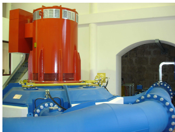
La turbina nella nuova centrale
